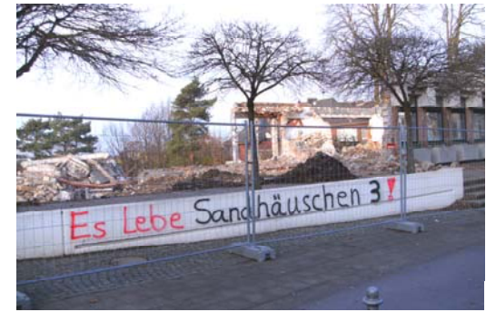
Das von Rot/Grün abgerissene Sandhäuschen
